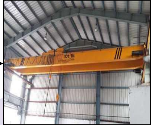
5 TON EOT CRANE
